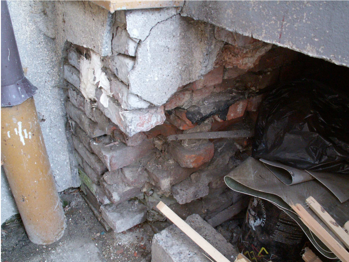
USZKODZONY MUR, POD SCHODAMI ZEWNĘTRZNYMI
