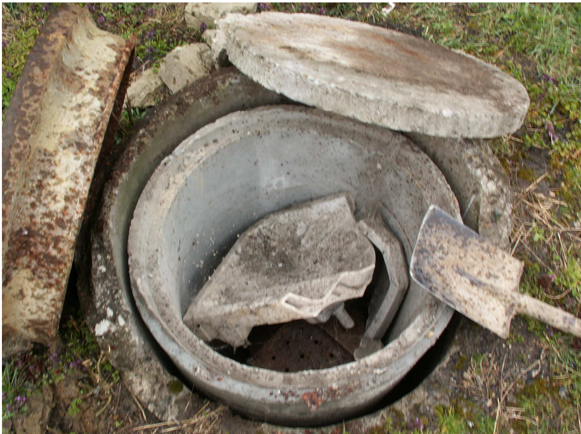
SKŁAD GRUZU W STUDZIENCIE REWIZYJNEJ
