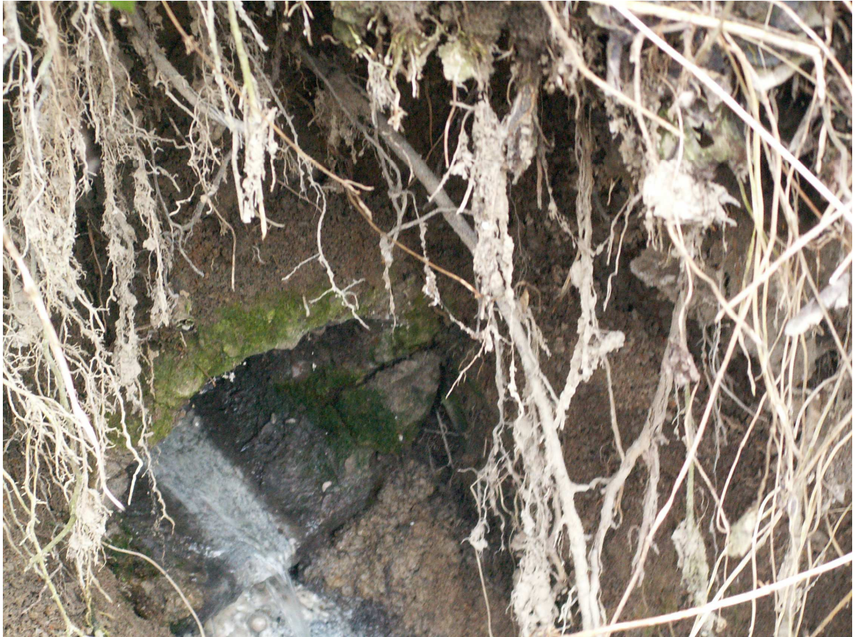
BRAK OBUDOWY WYLOTU KANALIZACJI, W SKARPIE POTOKU.
