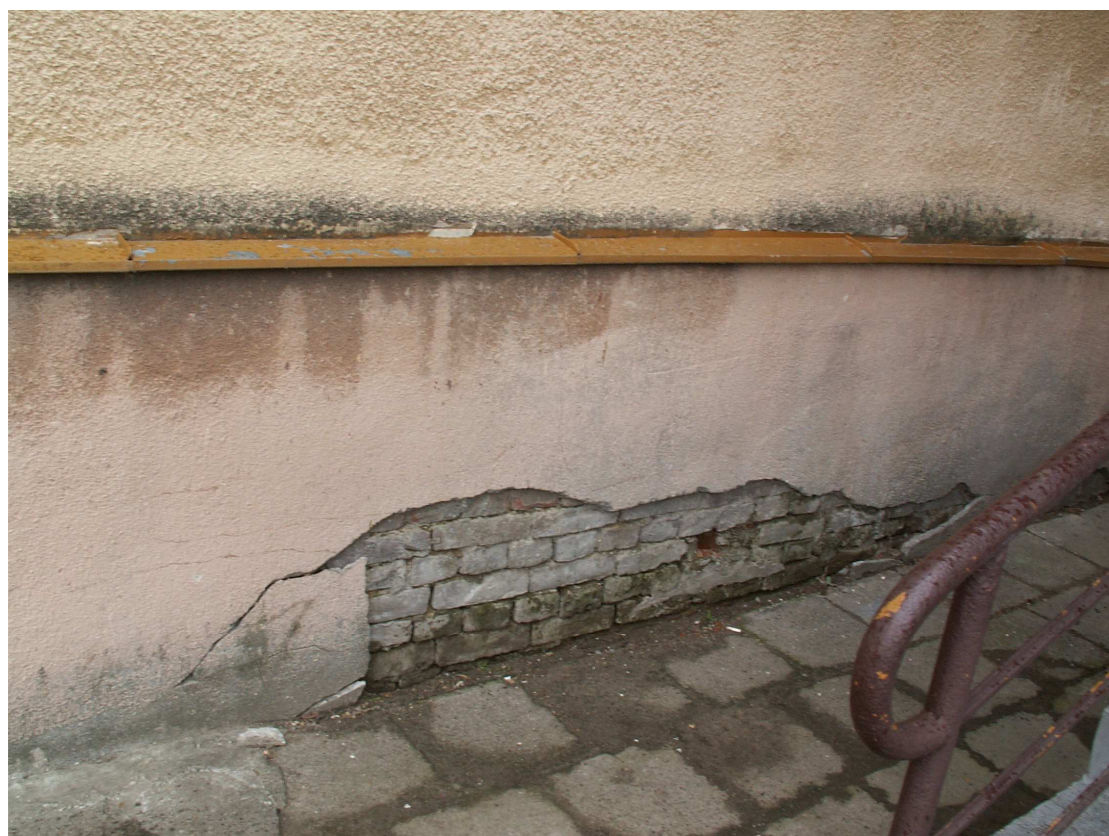
ZNISZCZONE OKŁADZINY ZEWNĘTRZNE COKOŁU BUDYNKU
