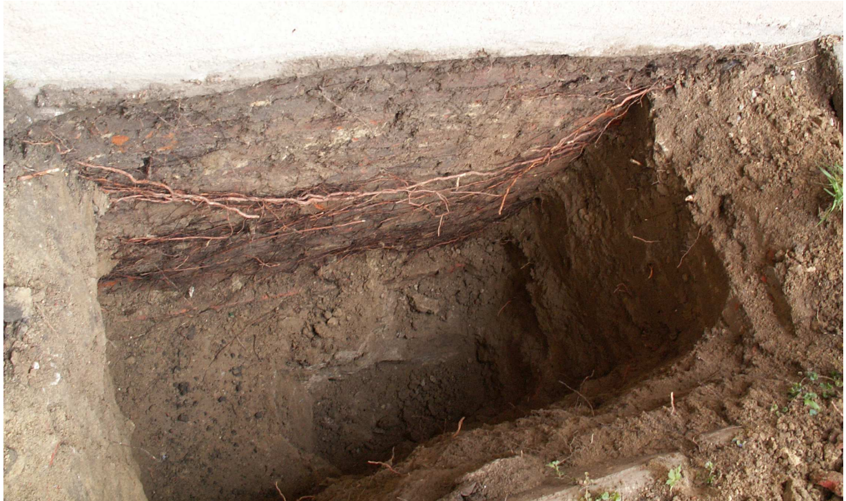
ODKRYWKA ŚCIAN FUNDAMENTOWYCH. BRAK IZOLACJI PIONOWEJ.
