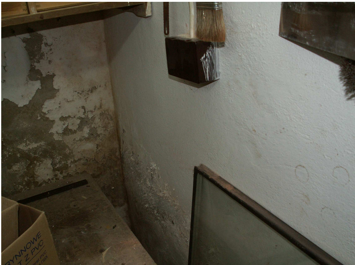
ZNISZCZONE TYNKI WEWNĘTRZNE W POMIĘSZCZENIACH PIWNICZNYCH
