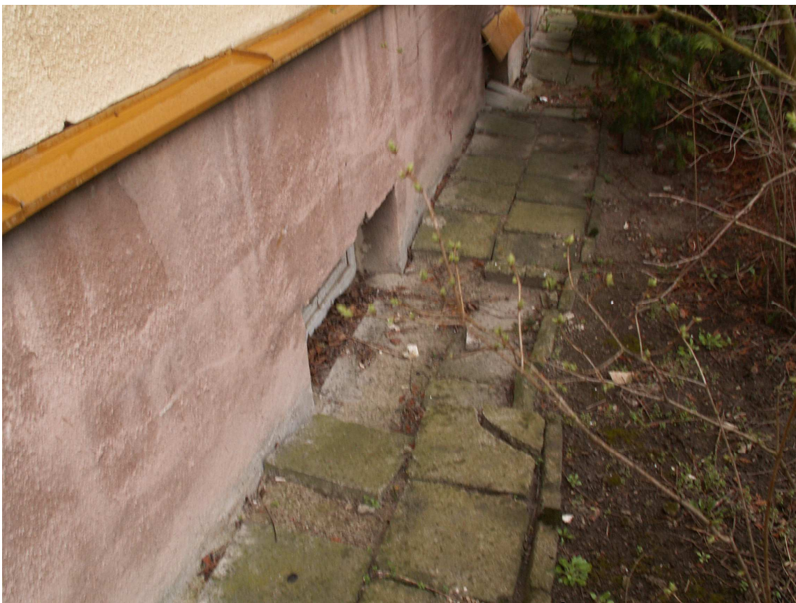
ZNISZCZONA PŁYTKA ODBOJOWA. BRAK SZACHTÓW PRZY OKIENKACH PIWNICZNYCH
